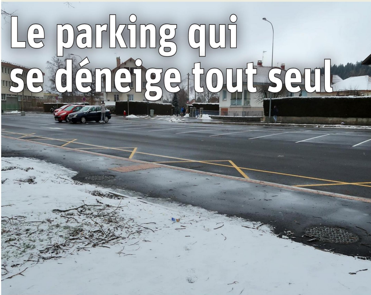
PONTARLIER Depuis près de six mois, la place Becquerel est dotée d'un procédé innovant, créé par l'entreprise Vermot de Gilley. Grâce à un système chauffant sous l'enrobé, la neige fond toute seule. Photo A.L. > PAGE 12
